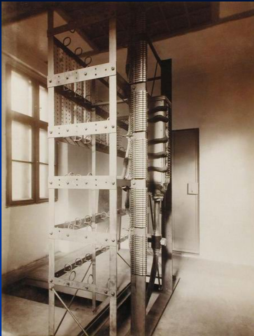
Kábelelosztó kamra a külső Kerepesi út 3. sz. tetőterében
