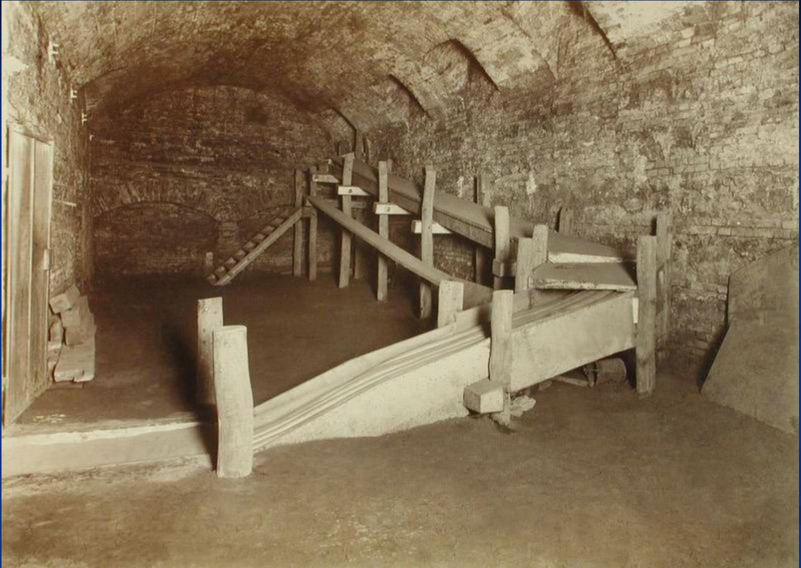
Kábelvezetés a Szerecsen utcai épület pincéjében
